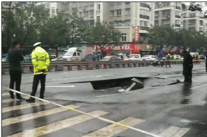
2018年11月22日 禹航路与南渠北路交叉口地面塌陷
