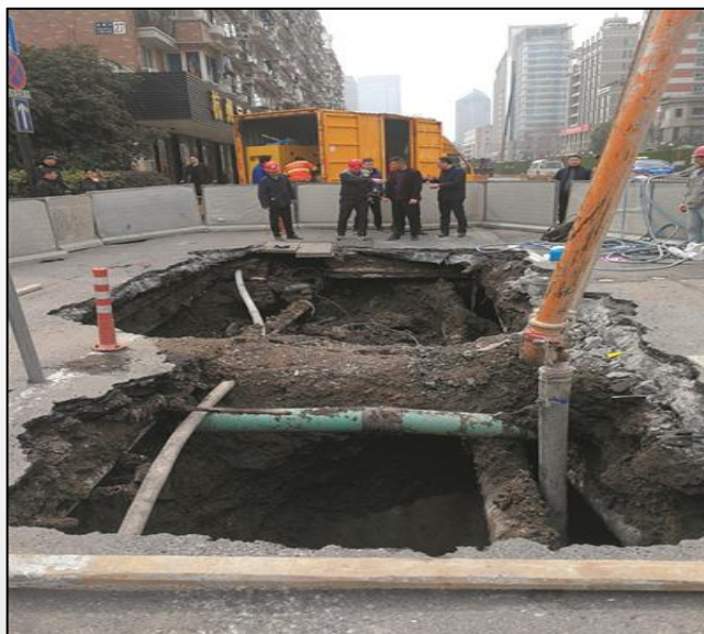
2019年3月7日 5号线万安桥站附近塌陷
