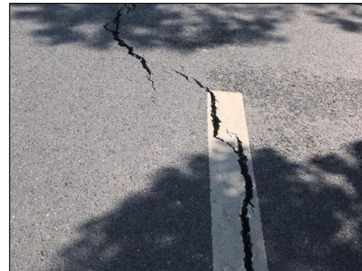
2021年5月10日 闻涛路江陵路路口附近路面塌陷
