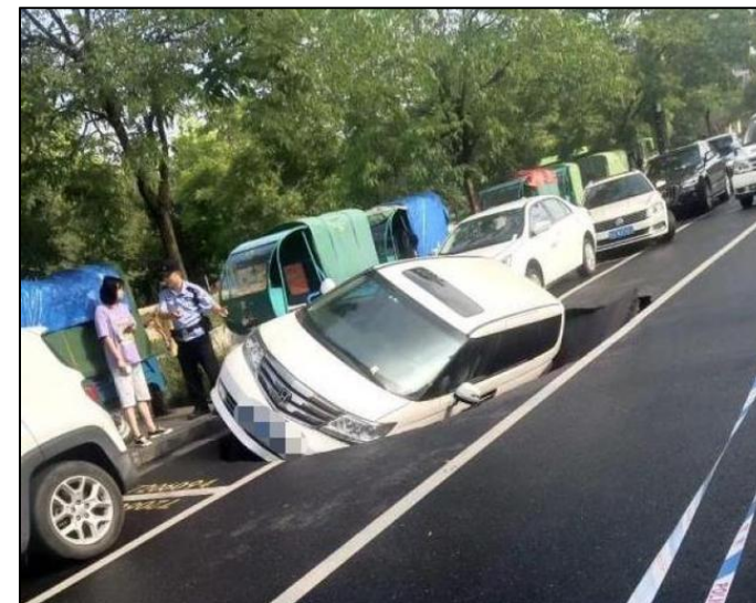
2020年6月30日 上沙路与学源街口路面塌陷
