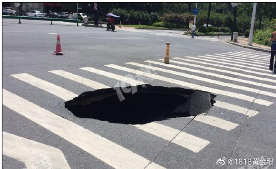
2019年9月10日 西兴路和丹枫路交叉口人行道路面塌陷
